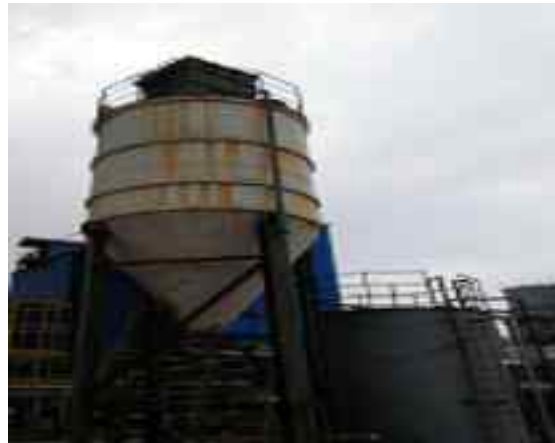
石灰石储存仓及除尘设备
