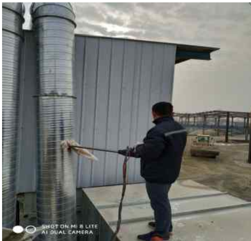
图 3：环保设备及现场采样照片
